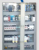
Coffret de commande
